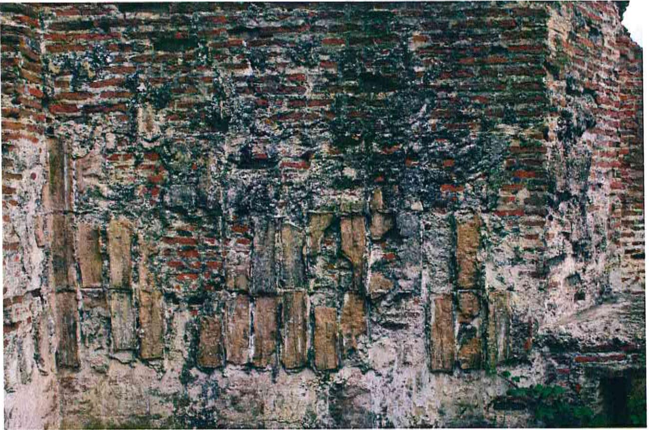
Figura 16 – I tubuli installati in parete per permettere la circolazione dell'aria calda
